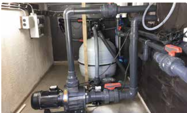
Bild 99. Exempel på insida nedgrävt teknikrum med en jetswim.
