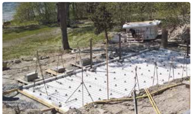
En fristående pool kan behöva extra förstärkning i form av fler förstärkningspelare.
