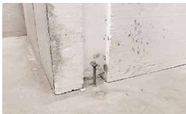
Bild 35. När bulten gjuts in i betongen fås en mekanisk förankring av trappan.
