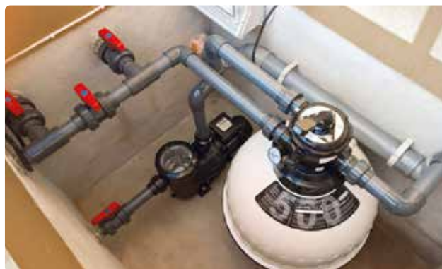
Bild 89. Teknikrum med endast pump och filter (standard).
