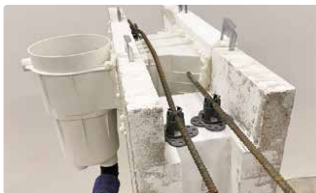
Bild 34. Det räcker att ett armeringsjärn löper över bräddavloppet.
