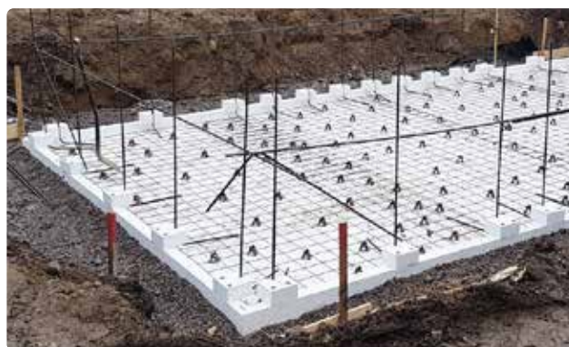
Bild 15. Armeringsvinklarna kan stabiliseras ytterligare genom att tillfälligt najas fast raka järn ca 1 m upp på armeringsvinklarna.
