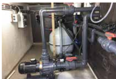
Bild 73. Exempel på insida nedgrävt teknikrum med en jetswim.
