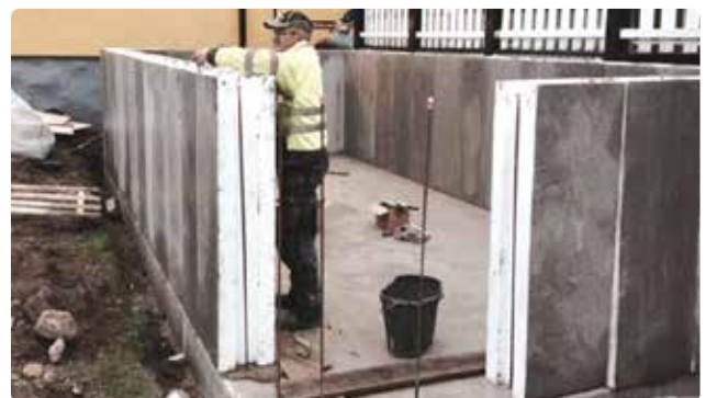
Vinklade armeringsjärn gjuts in i plattan. Vägglocken placeras sedan så att järnen hamnar i urtagen på blocken.
